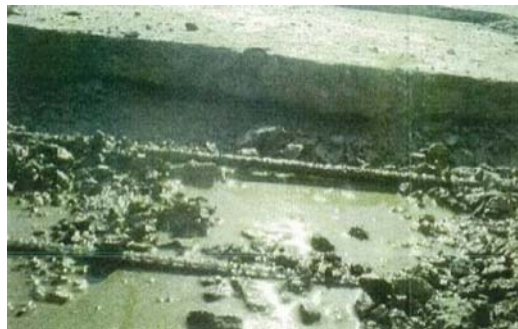
写真－1 コンクリート床版の砂利化
