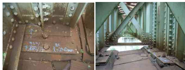
下フランジの亀裂
