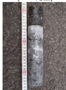
No.7 (水平ひび割れ)
