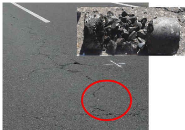
写真1 浸透水によりはく離・土砂化した基層
