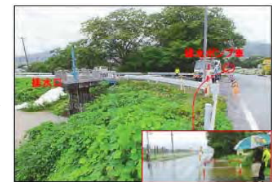
写真-2【排水ポンプ車による内水排水状況】
