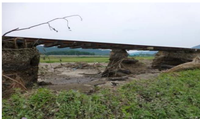
図-6 線路盛土の被災状況
