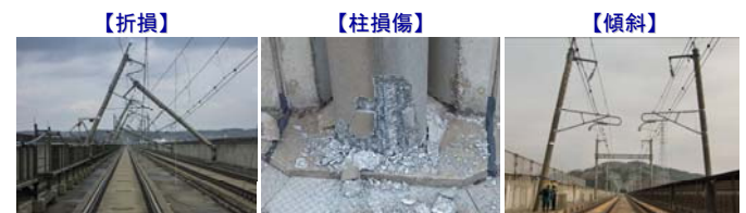
図—1 電化柱の損傷状況
