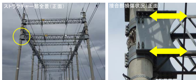
図-4 特殊箇所(ストラクチャー部)の損傷状況
