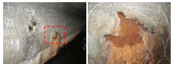
写真 2【69 年経過】函体側壁の錆汁
