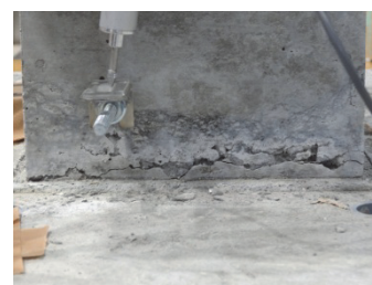
写真-2 柱基部の損傷状況 (sine 波入力)
