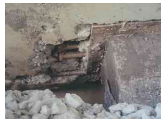
写真-1-1 ストッパー部の損傷状況
