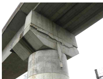
写真-3-1 架け違い部の損傷状況
