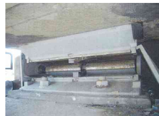
写真-2-2 ローラー沓の損傷状況
