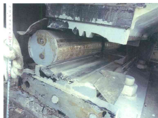
写真-2-1 ローラー沓の損傷状況
