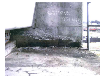
写真-3-2 架け違い部の損傷状況
