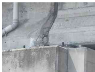
写真-2-3 桁同士の損傷状況
