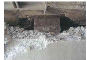
写真-1-2 ストッパー部の損傷状況
