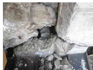
写真-2-4 桁同士の損傷状況
