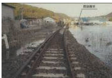
写真－1 既設護岸（震災後）
