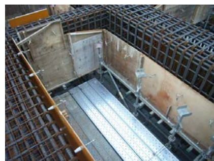
写真－3 開口部の安全対策
