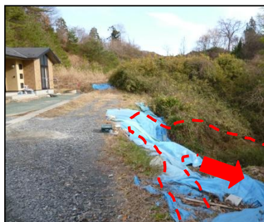
写真-1 地すべり頭部
