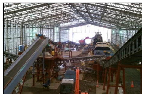
図 2 破碎・選別機の設置状況
