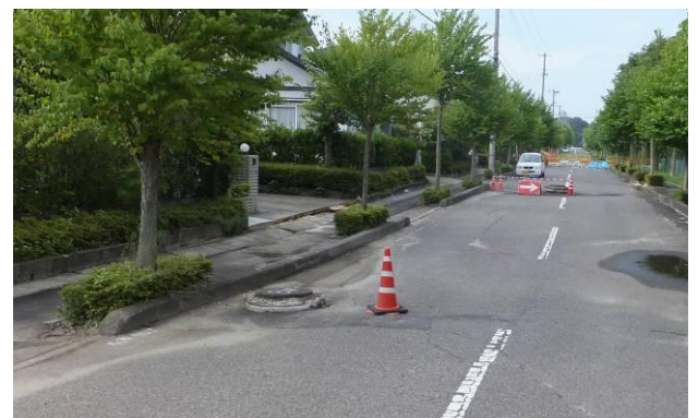
写真-1 造成地内部でのマンホールの浮き上がり
