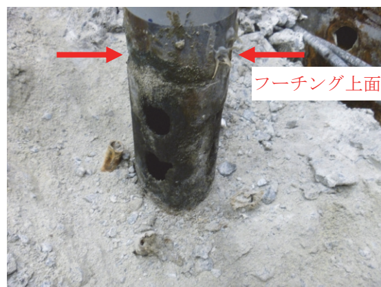
写真-1 鋼管の腐食状況 (HK100)
