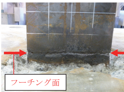
写真-1 柱基部の腐食欠損
