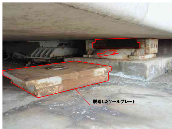
写真-1 脱落したソールプレート（4P）
