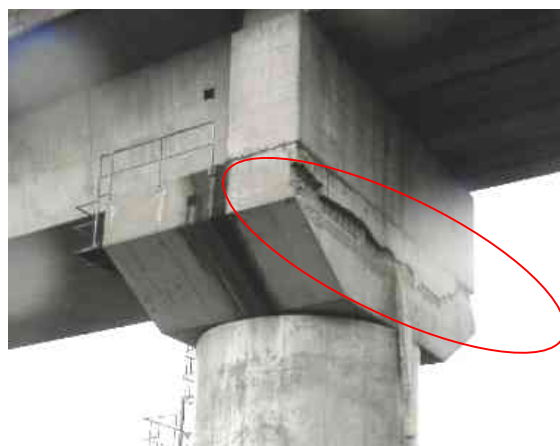
写真-2 パラペット背面のコンクリート剥落（1P）
