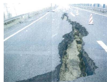
写真-1 道路被災状況
