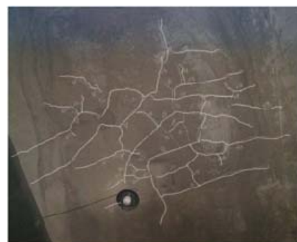
写真-1 覆工変状(変状区間 A)
