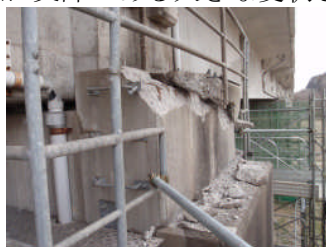
写真2 桁ズレ変状例
