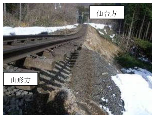
Photo.1 盛土崩壊状況
