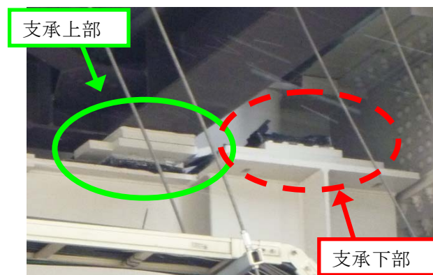
図-2 ゴム支承破損状況
