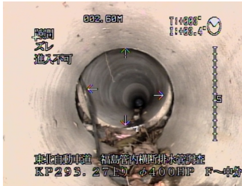
写真-2：損傷状況（接合部のズレ）
