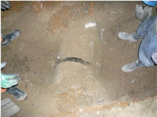
写真-1：破損状況
