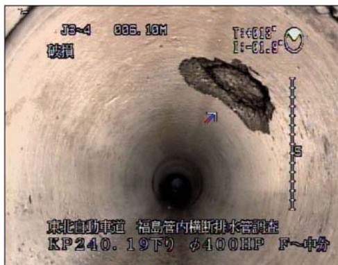
写真-3：損傷状況（破損）
