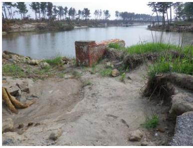
写真-1 津波で損壊した下の橋 (2011年6月5日撮影)
