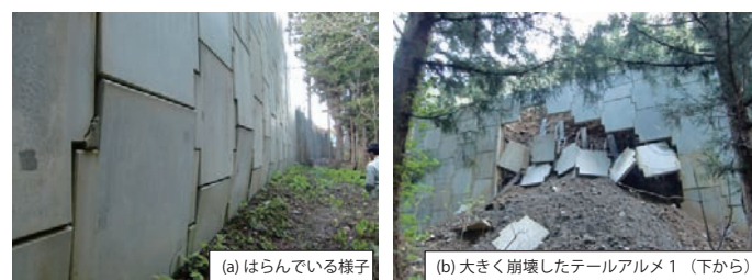
図-3 崩壊したテールアルメ擁壁（岩手県一関市）
