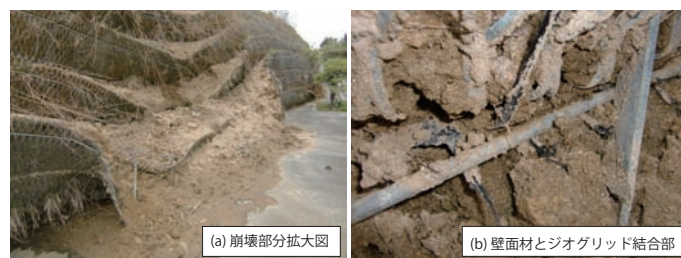
図-2 ジオグリッド補強土壁の被害(奥州市水沢区)
