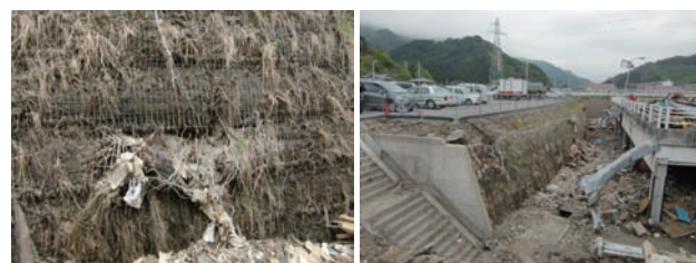
図-5 補強土壁壁面の損傷（大槌町）
