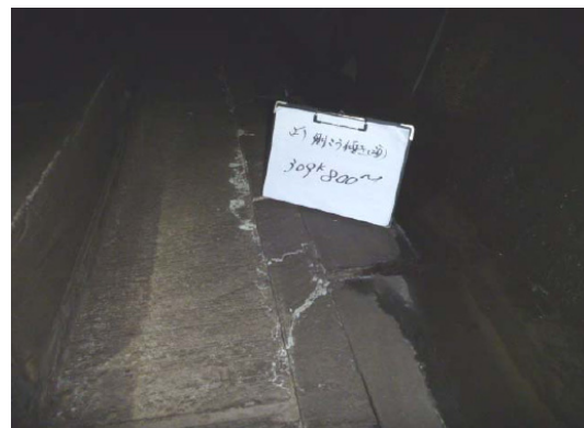
Photo.1 路盤部の亀裂
