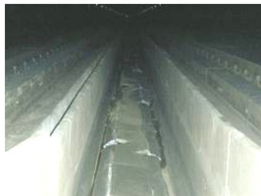
Photo.2 中央通路の亀裂、隆起
