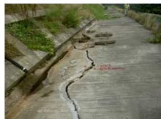
写真－2 第1小段の亀裂
