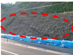
写真－1 のり面のはらみ
