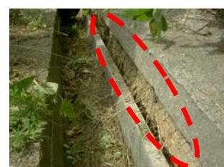
写真－3 第3小段の側溝沈下
