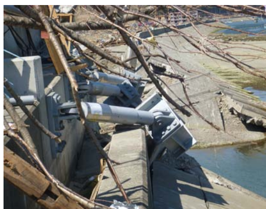
写真-2 気仙大橋の落橋防止装置
