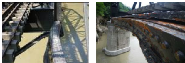
写真-1 下弦材の損傷状況
