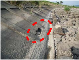
法枠護岸での欠け
