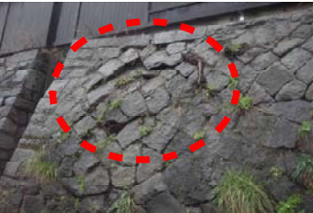
石積み護岸のはらみ出し
