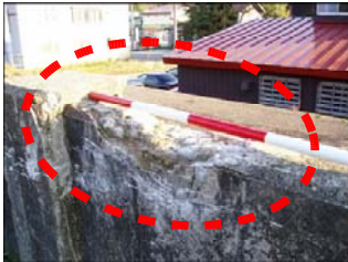
特殊堤の劣化による破損
