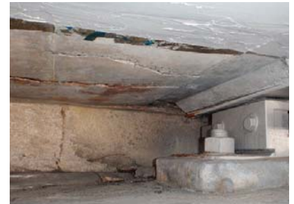
写真-1 狭隘部損傷状況
