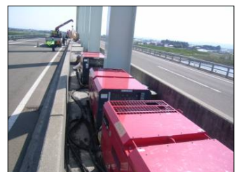
写真-9 コンプレッサー設置状況
