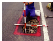
橋梁の床版が抜け落ち、 緊急対応を実施した事例 〔信夫橋(一)水原福島線〕
