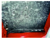
橋梁の床版の損傷状況 (多数のひびわれが発生)
