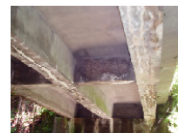
コンクリート橋の主桁の損傷状況 (ひびわれ、遊離石灰が多数発生)
