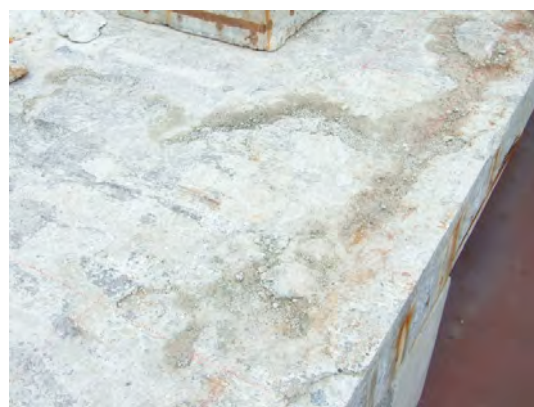
写真-1 土砂化現場より切り出された床版
