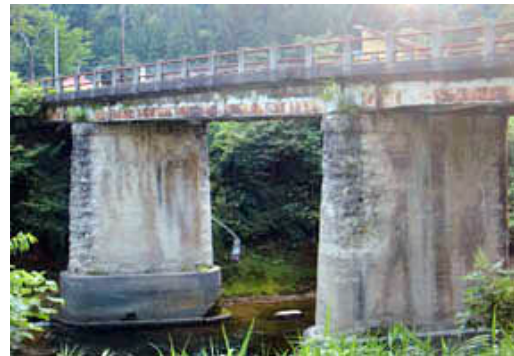
写真-1 調査対象の凍害橋梁
