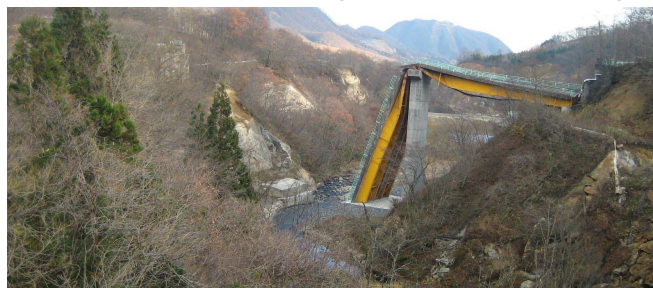
写真-2 被災した祭時大橋（H22年11月20日撮影）
