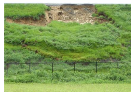
写真 2.H19.7 台風における盛土の崩壊 （植生が成長している）
