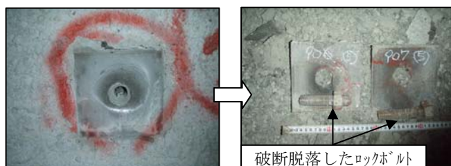
写真-3、4 ロックボルトの破断状況
