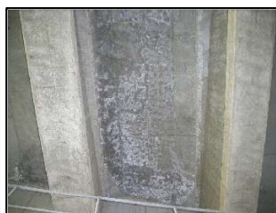
写真-5 床版下面の損傷
