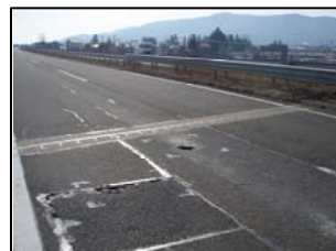
写真-3 舗装の損傷 (橋梁部)
