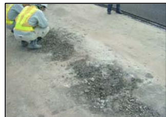
写真-4 床版上面の損傷
