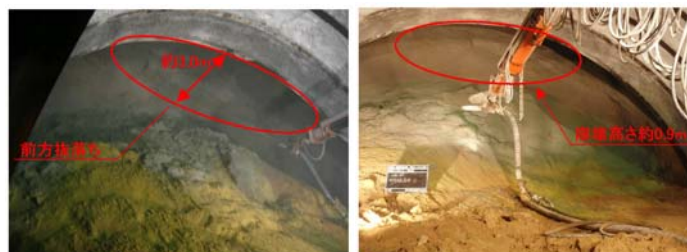
写真-1 無拡幅支保工部における天端崩落・切羽崩壊
