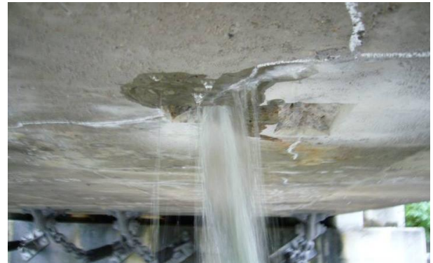
写真 1 床版下面からの出水状況
