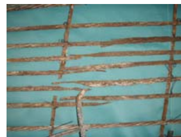
写真-3 4-3-G1 最劣化部位
