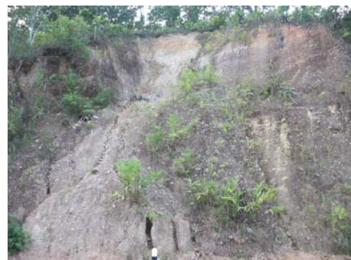
写真 2 地点 4 法面崩壊
