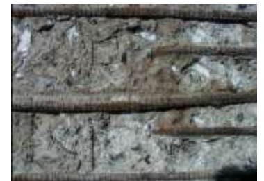
(2) 鉄筋の腐食進行
