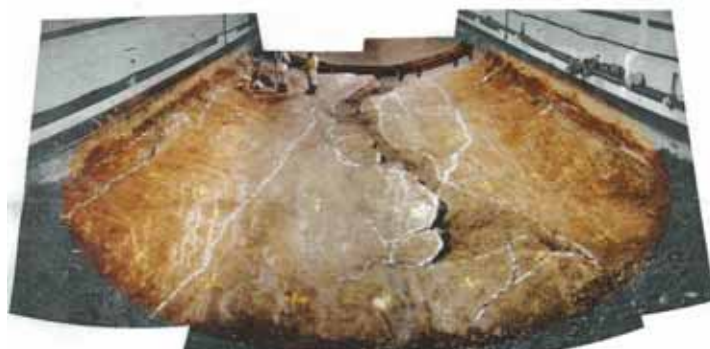
写真 - 2 既設インバート損傷状況
