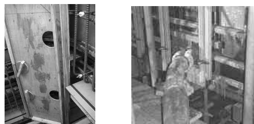
写真2. 充填確認窓（左） シャッターバルブ（右）
