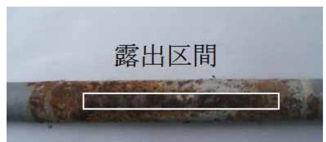
写真 1. 腐食後の鉄筋
