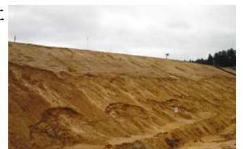
写真－1 降雨による法面崩落状況
