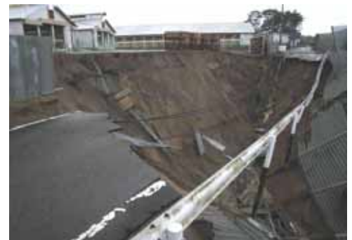
●図2——切土法肩上部の崩壊状況
