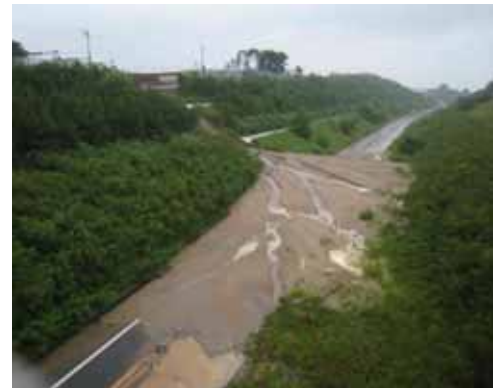
●図1——切土法面崩壊全景
